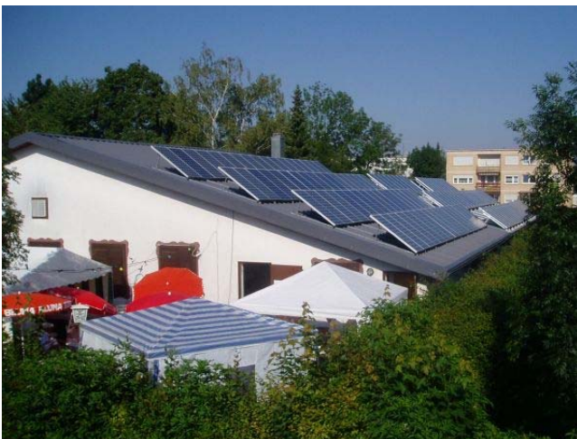
Vereinsheim mit Photovoltaikanlage
